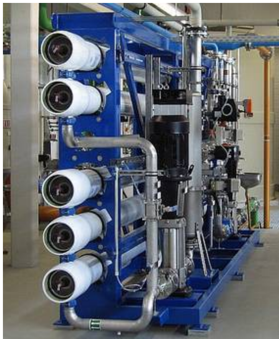
Nanofiltrationsanlage, Quelle: Zweckverband Wasserversorgungsgruppe Mühlbach, Bad Rappenau
