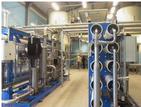
Umkehrosmose-Anlage, Quelle: Stadtwerke Bad Dürkheim
